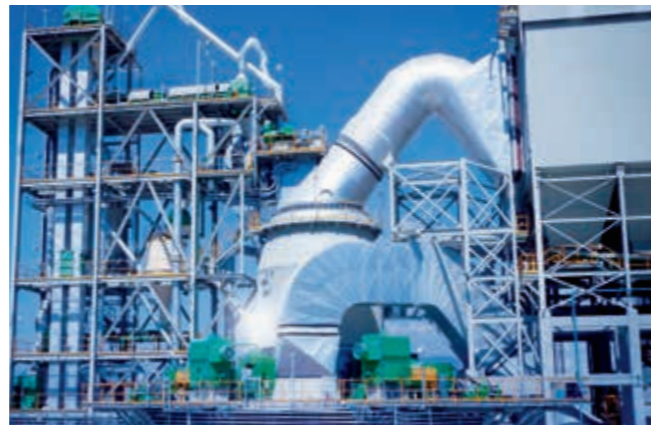
In Mexiko steht die größte QMC 2 -RD mit 4 x 1.800 Kilowatt Leistung und einer Kapazität von 300 Tonnen pro Stunde.
